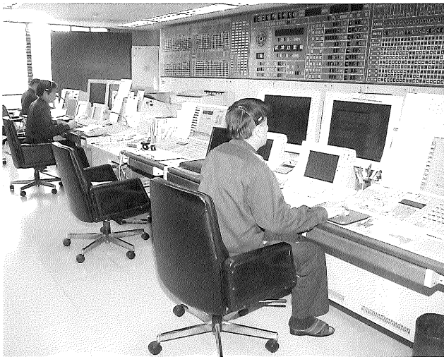
▲通信室の様子
